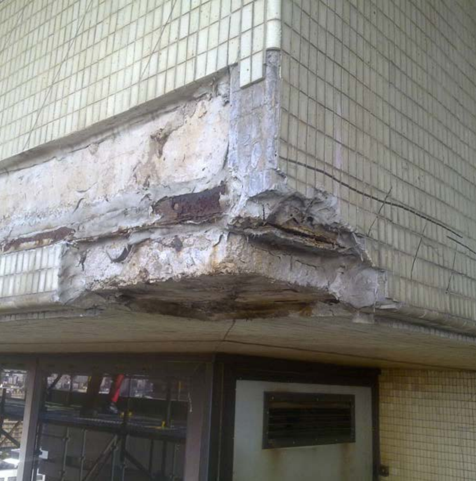
La torre de Pretoria antes de la renovación: desde su construcción a finales de los años setenta, el tiempo ya había cobrado factura en la estructura básica del edificio.
